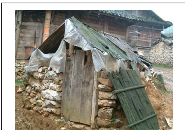
簡素な農家のトイレ。まだ屋根や壁があるので良いほうと言える。
