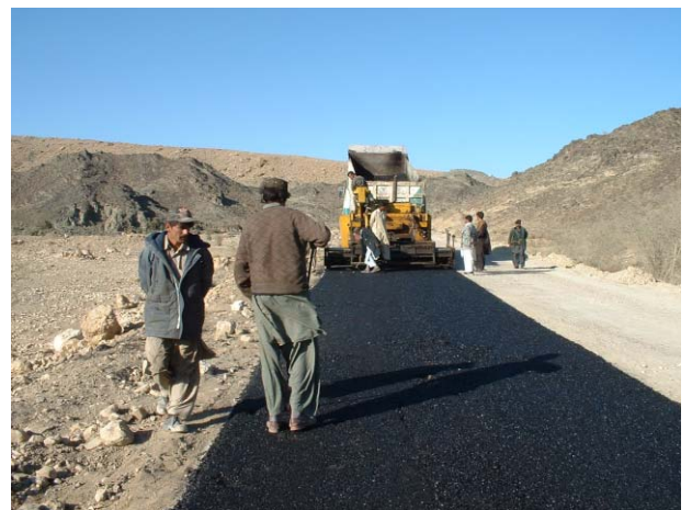
ウッド側（始点より65km付近）でのNHAによる道路維持管理工事
