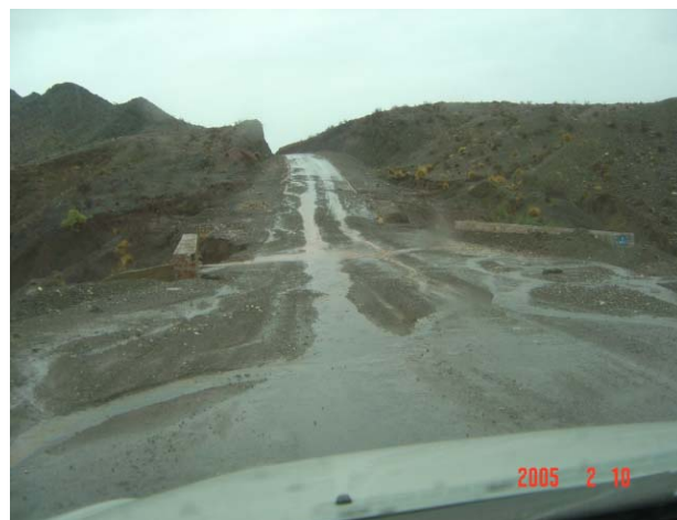
降雨時の不十分な路面排水 (水を跳ね上げ安全走行上問題となる)
