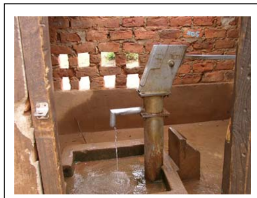
写真 3-16 日本の建設した一部井戸に UNICEF 援助によるハンドポンプが設置されていた。
