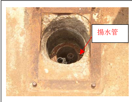
写真 3-3 スタックした揚水管
