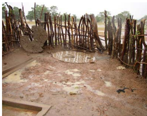
写真 3-18 排水不良を起こしている井戸
