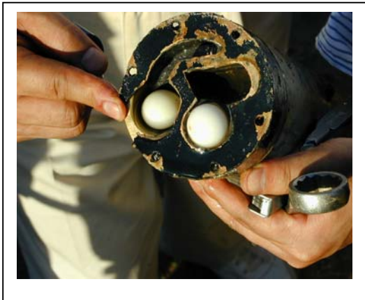
写真 3-5 破損したガスケット
