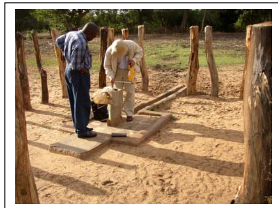
写真 3-20 現地業者が途中で放棄した井戸 (18mまで掘削した)。
