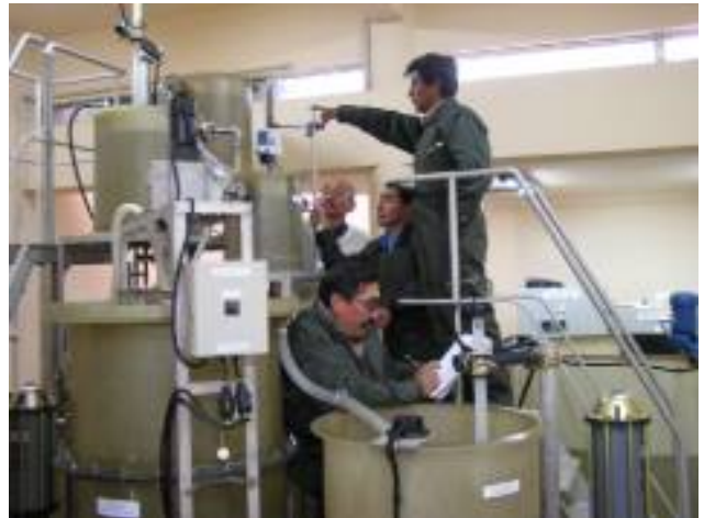
連続中和試験プラント
