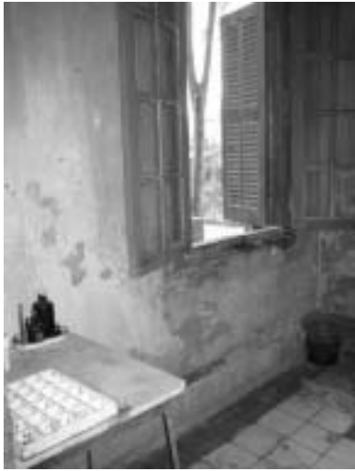
検査室 （建物の老朽化が進み、機能性が不十分）
