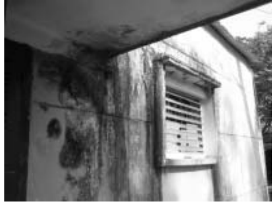
既存病棟 （老朽化がすすんだ病棟）
