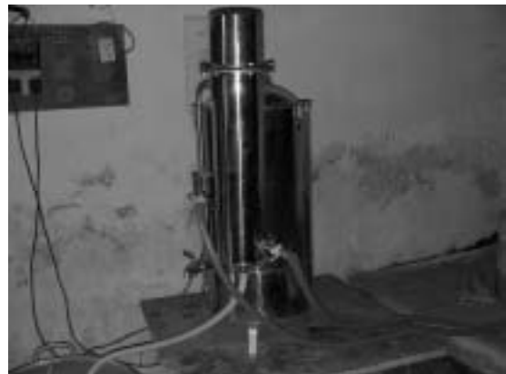
滅菌室 （蒸留水製造装置；正常に稼動）
