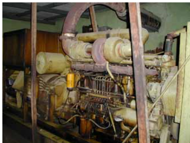
写真-28 Medical Store (CAPP)のスタンバイ発電機。250KVA、1979年イギリス製であるが、現在も使用可能である。 <ラゴス州>
