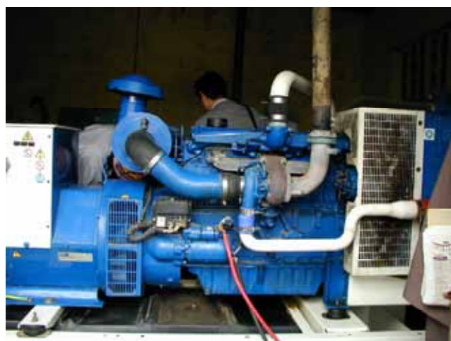
写真-30 ラゴス・オショディ中央冷蔵倉庫にあるスタンバイ発電機(160KVA)。しかし故障しているため、他の55KVAのものを使用している。
