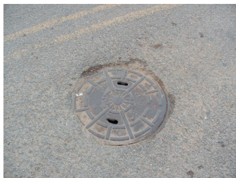
道路に埋設されている雨水排水管路のマンホール
