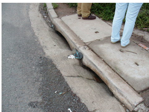
雨水排水口（Dos Alvarenga V地区）
