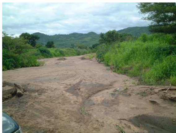
写真-8:ナンヤングカルバート
