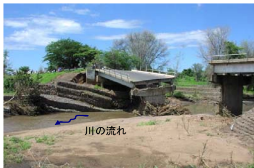
橋脚と蛇かご護岸が局所洗掘により沈下している。
