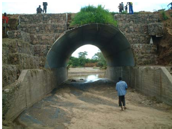
写真-7:ナンヤングカルバート
