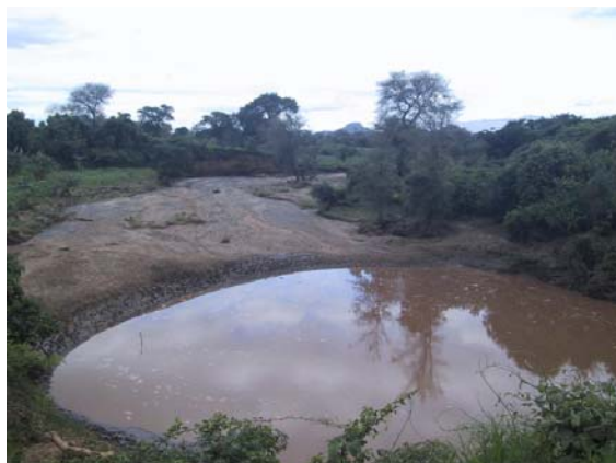
写真-9:ナンヤングカルバート
