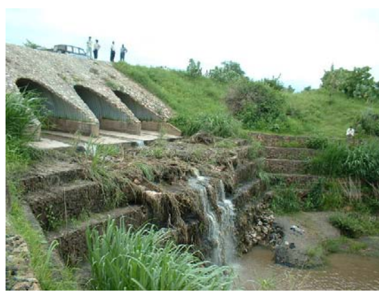
写真-10:アングニカルバート
