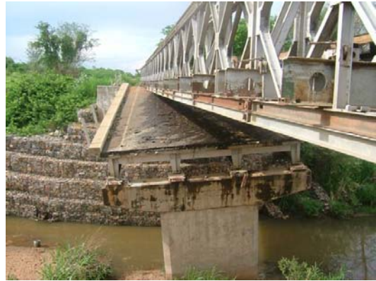
写真 2-3 上流側に沈下・傾斜しているサリマ側橋脚
