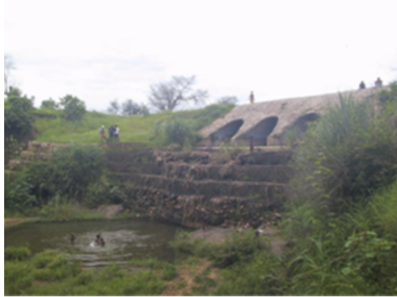
現況:長年河岸浸食、河床低下を放置してきたため、カルバート直下流に約6mの高落差が生じている。応急処置の蛇かご落差工の基礎部は河床の洗掘によって浮いた状態にあり危険である。
