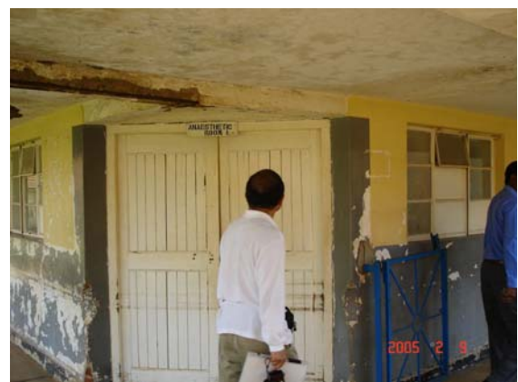
手術室入り口：渡り廊下より手術室への入り口。梁の部分の劣化が著しい。
