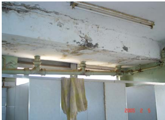
ブギリ総合病院 病棟トイレ： 給排水系統からの漏水が激しい。
