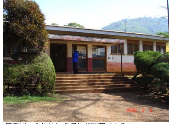
管理棟：全体的に老朽化が顕著である。
