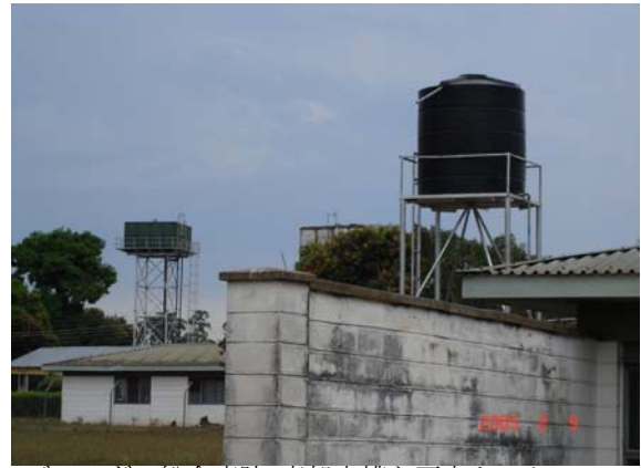
ブソルヴェ総合病院 高架水槽と雨水タンク： 専用井戸で汲んだ地下水を48tの高架水槽に貯水。
