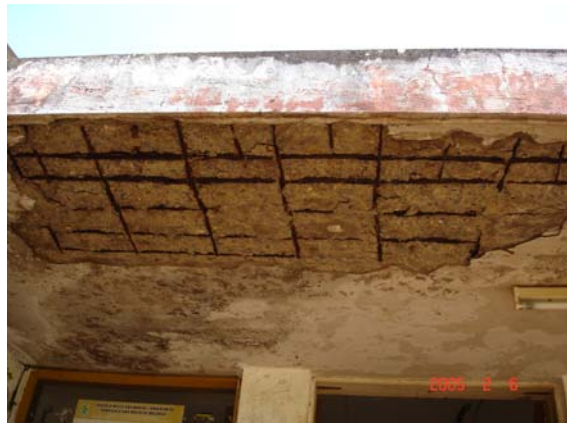
管理棟底：鉄筋が錆びて、モルタルが剥落した。継続使用が困難な状態である。
