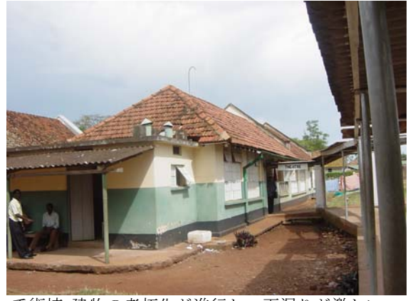
手術棟:建物の老朽化が進行し、雨漏りが激しい。
