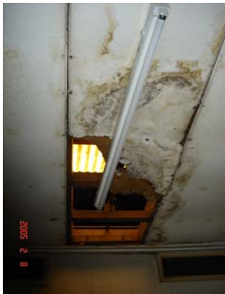
外来棟：雨漏りが激しく、天井が損傷している。
