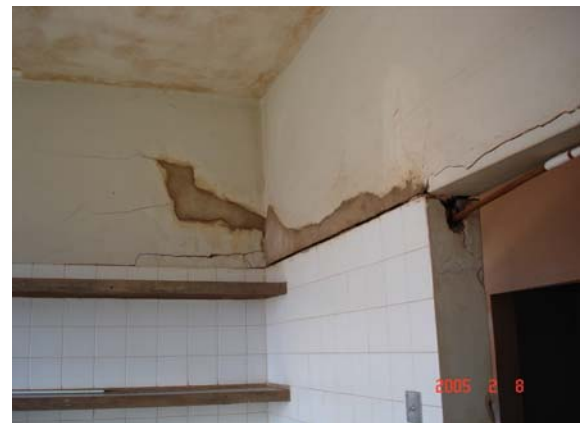
手術棟：不同沈下が激しく、クラックが多数発生。継続使用は困難な状況である。
