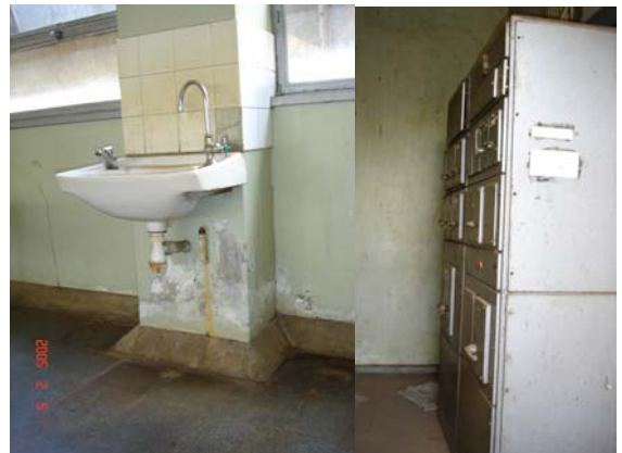
ブギリ総合病院 病棟給排水と配電盤： 給排水・電気設備とも老朽化・故障が目立つ。
