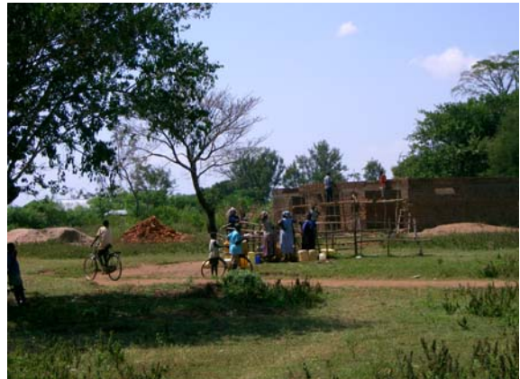
トロロ県バヤンガシ保健センターⅢ： 新たな施設を建設中
