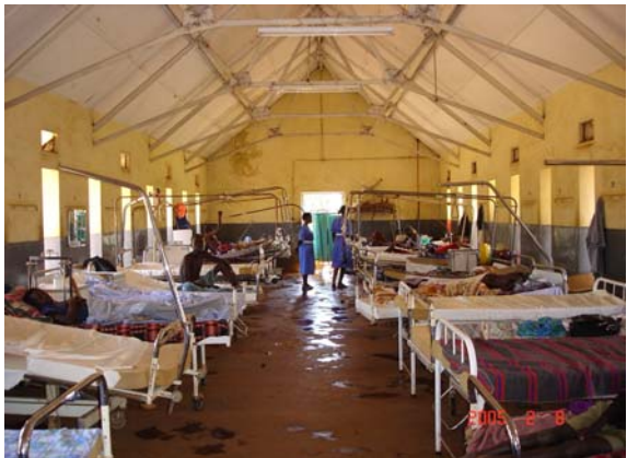
男性病棟:劣化が進んでいるが、トラスが鋼製であり、女性病棟よりは程度が軽い。
