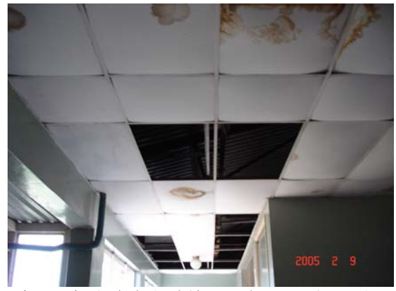
ブソルヴェ総合病院 病棟天井ボード:湿気・雨漏りにより変形が多い。欠損は風が原因である。
