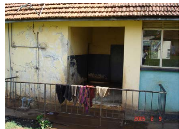
産科棟外観：設備の漏水、塗装の劣化が目立つ。
