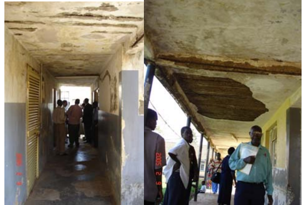
X線棟の中廊下(左)、病院中央の渡り廊下(右)ともにスラブの劣化が顕著である。
