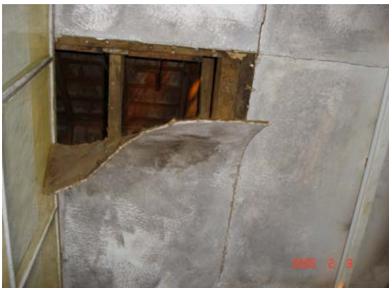
手術室天井：天井が雨漏りにより剥がれている。衛生的な環境が保てない状況である。
