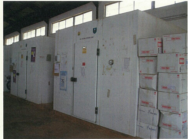
写真-12 アブジャのNPI用コールドルーム ナイジェリア政府は、UNICEF・WHO 支援の基に独自の予算でNPI 倉庫を設置。各6地政学的区域に配布できるよう、6台の冷蔵庫も保有している。冷蔵庫内温度管理、在庫管理等も基準に基づいて行われており、配布計画も明確であった。
