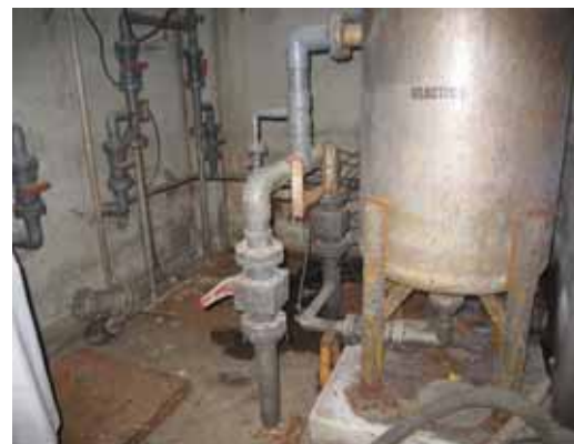
既存排水处理装置
