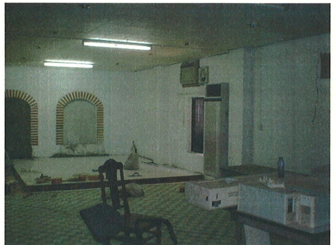
CMAC本部施設内 コンピュータ室 浸水にも対応できるように床を上げ、改装中。空調機も新規に設置。
