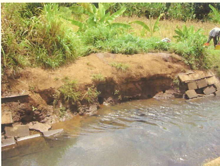
ローアモシ灌漑地区 幹線用水路が、建設後 20 年弱経過し、一部 に老朽化の影響が出始めており、コンクリー トライニングの崩落が 10 カ所以上確認され ている。
