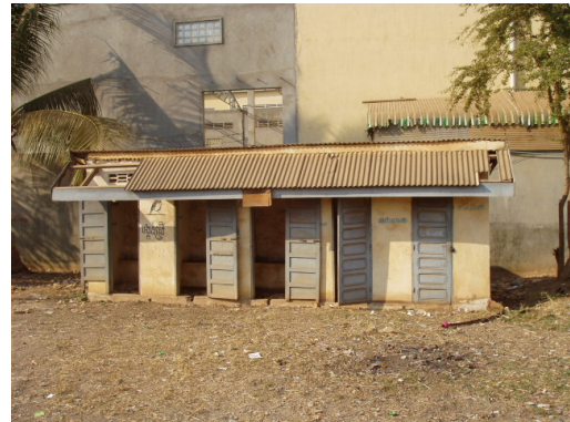
既設便所：既設の便所 10 ブースのうち、5 ブースは使用不可能となっている。新校舎建設位置と重なるので取り壊す予定である
