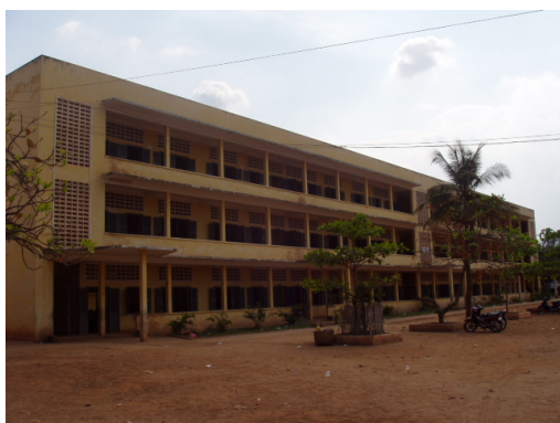
3階建・RC造の校舎 校庭は本計画対象校の中で最大の広さを有する
