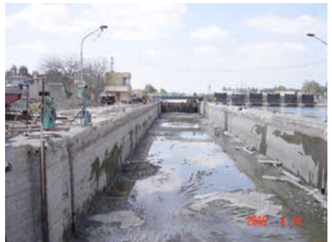
写真5 「ブスタン閘門」のチャンバー内部。定期の維持補修中でドライの状態。前方閘門上方はスイング橋、右はバラージ。
