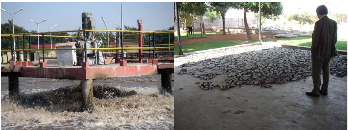
2次処理施設と汚泥乾燥場
