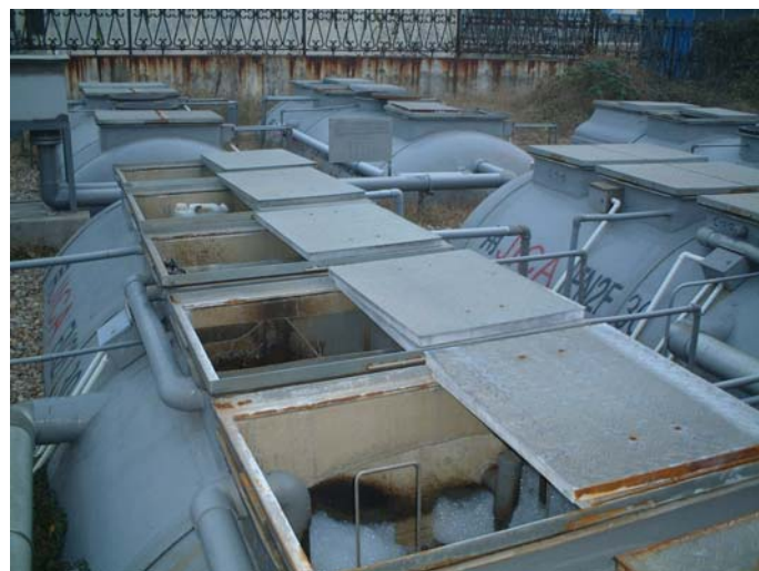
無錫における本プロジェクトの高度処理浄化槽実験施設。6種12基ある。
