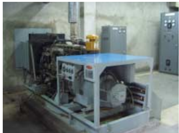
100kVA 非常用発電機
