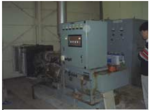
非常用発電機
