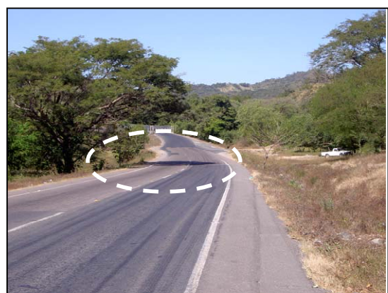
写真 3.2.2.1-3 ベアリー橋南側取付平面線形の急変
