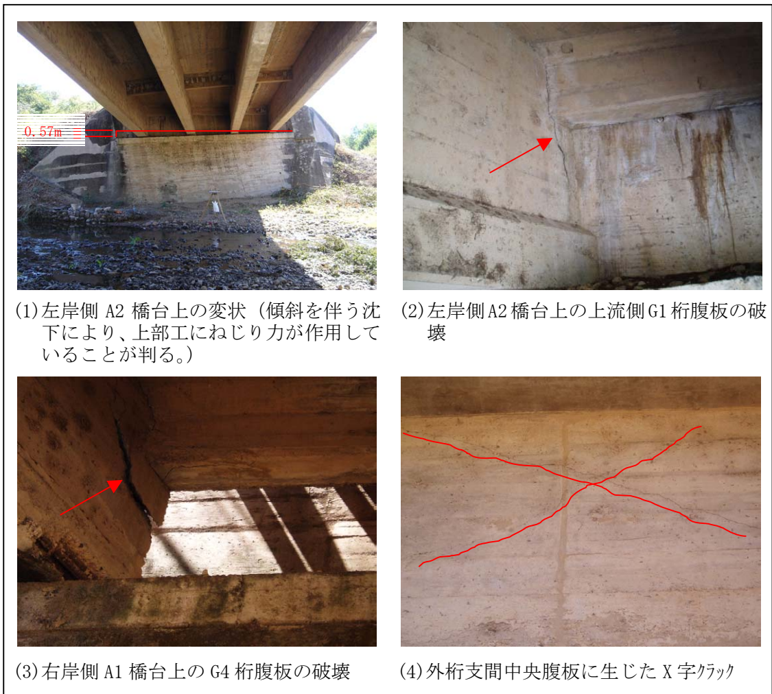
写真 3.2.2.1-1 上部工桁の損傷状況
