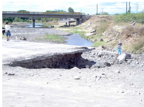
スピルウェイの損傷
