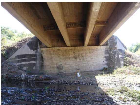
橋台の沈下・傾斜
