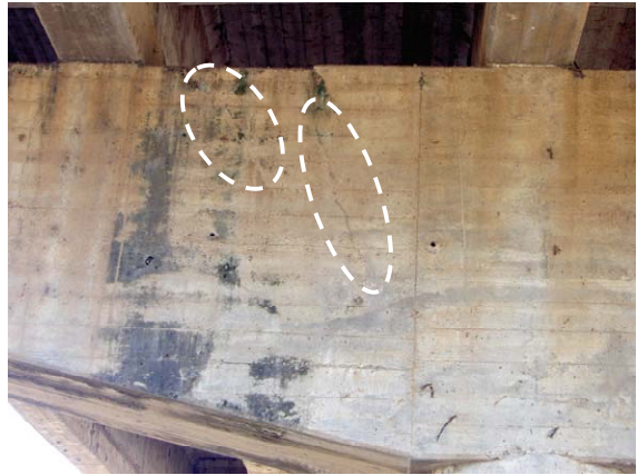
橋脚のひび割れ
