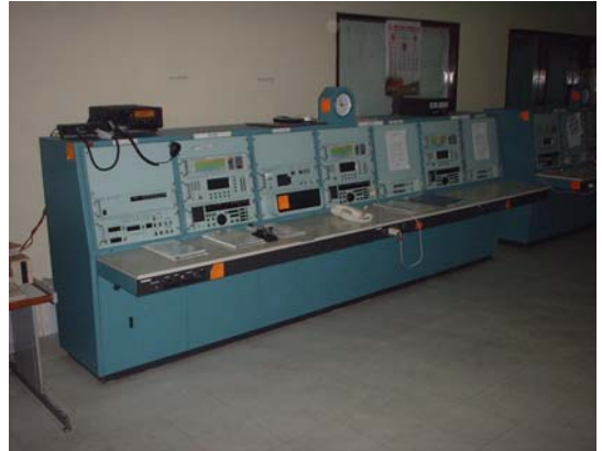
マニラ海岸局オペレーションセンター運用室
