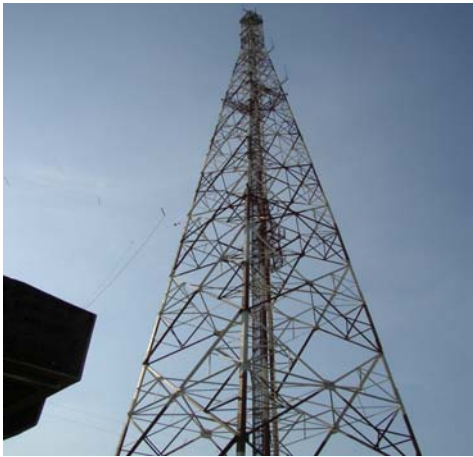
マニラ海岸局オペレーションセンター鉄塔
