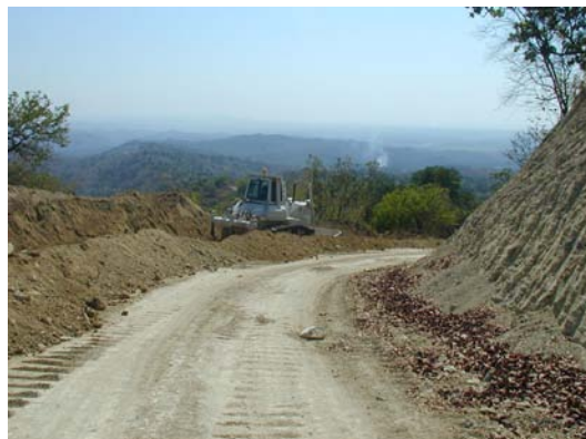
DRBFC の直営事業ベコ～ロロイ間の新設道路 土工事中の JEG 残置機材のブルドーザ
