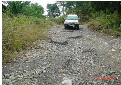
DBST 舗装の剥がれと劣化
