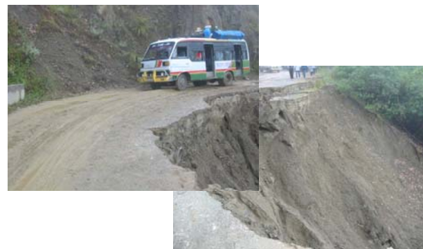
山地部道路の谷川の斜面崩壊
