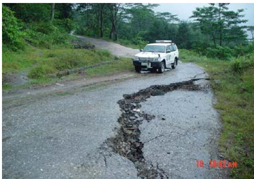
盛土部の滑りによる舗装亀裂
