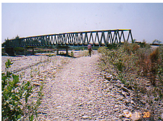
洪水で橋梁取付道路等を流失したモラ(Mola)橋
