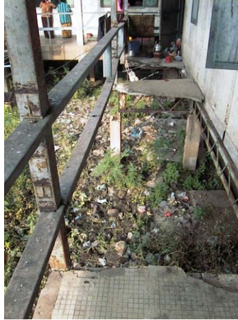
外科病棟 バルコニー コンクリートの床が破損し、通行不能になったバルコニー。
