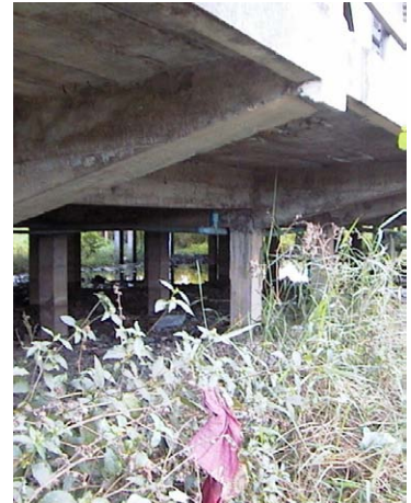
産婦人科病棟 床下 爆裂が見られ危険な状態の床下の基礎部。
