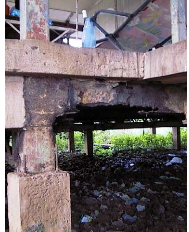
外科病棟 床下 老朽化が著しく危険な状態の床下の基礎部。
