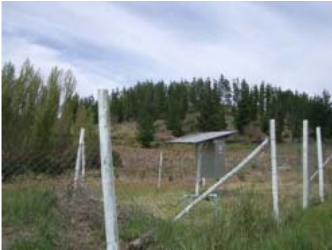
集会所横に設置された太陽光発電機。データ収集を行いながら、その展示効果により住民の興味を引いている。
