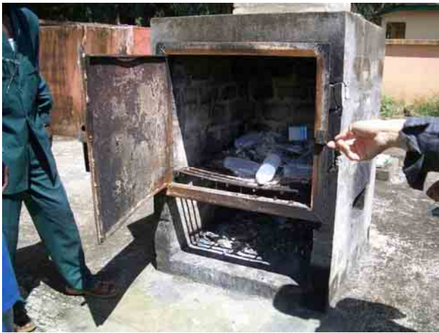
Incinérateur de l'hôpital du département de Foregalia
