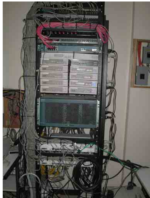
NAIA に設置された回線ラック
