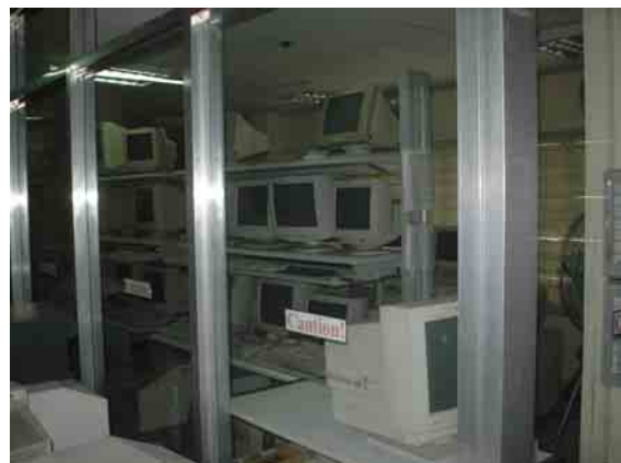
CCC のサーバー室
