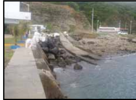
崩壊したスリップウェイ （岸壁北西端より）
