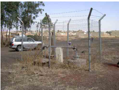
写真-3 ECDF による深井戸 B-17 2000年掘削、2004年から配水網の水源として揚水を開始したが、6ヶ月後には10分程度で水位降下によりポンプ停止するようになり現在は使用していない。
