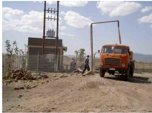
写真-2 JICA 開発調査による深井戸 DEB-1 ECDF によりポンプ場が建設され、タンカー給水と配水タンク（難民用に建設、20m 3 ）に送水されている。
