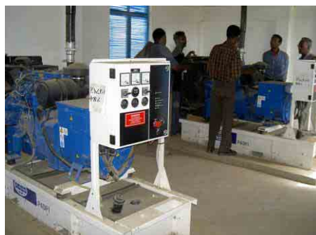
写真-16 ECDF によるポンプ用発電機 PW-2 と PW-3 に設置された電動式の揚水ポンプの電源として、2002 年 4 月に発電機(40kVA×2 台)が設置された。導水管と配水タンクが未整備のため使用していない。
