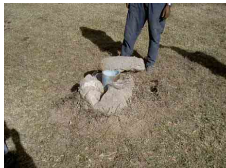
写真-30 深井戸 BH-5 開発調査の計画で使用予定となっている。コンクリート で密封されていたが、壊されて開口している。孔内にゴミ が詰められており水は確認できない。使用不能。
