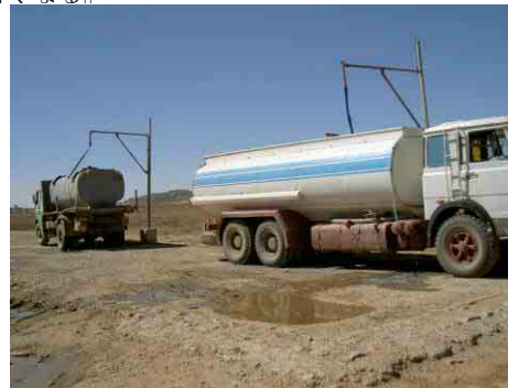
写真-20 JICA 開発調査による深井戸 DEK-2 ECDF が 2001 年にタンカー給水用施設（水中ポンプ、送電線、ポンプ小屋、トラック用水栓）を整備した。一日にタンカー13台が利用している。稼動状況良い。
