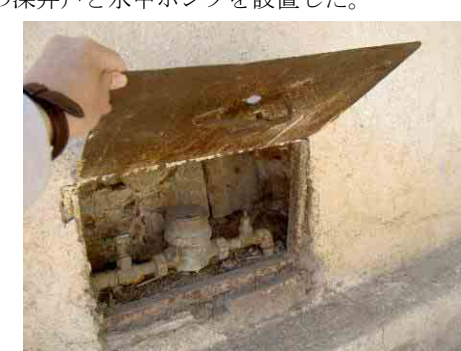
写真-24 各戸給水の水道メーター 各戸給水では、このような水道メーターにより従量制の料金徴収が行われている。古い機種はポーランド製で新しい機種はイタリア製。
