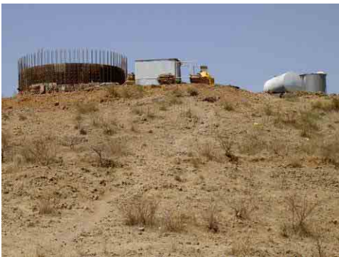
写真-7 既存配水タンクと建設中配水タンク ECDF により建設中の配水タンク（500m 3 ）は2005年6月に完工予定。既存配水タンク（右端）は2個で24m 3 。
