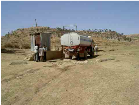
写真-29 深井戸 BH-4 水中ポンプが設置されトラック給水（2台×2回）で利用 されている。電源はディーゼル発電機。市内への送水 システムに接続しているが使っていない。
