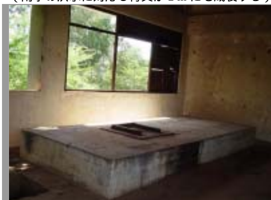
揚水機場内部
