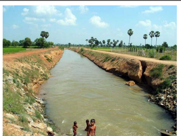
写真：11月19日のローレンチェリ南幹線水路。ADB建設の制水ゲート下流部右岸側が浸食により崩壊。「Dispersible Soil」と呼ばれる砂質土のため浸食に弱い。周辺からの流入水によるのり面浸食も進んでいる。
