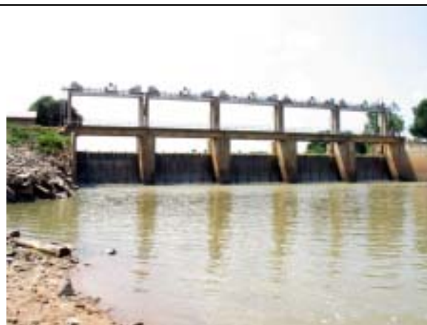
写真-6: 2003年11月19日。ローレンチェリ頭首工。越流水深 m (WL=7.12 m)。ゲート操作用の発電機、モーター、ケーブルを改善または改修する必要がある。
