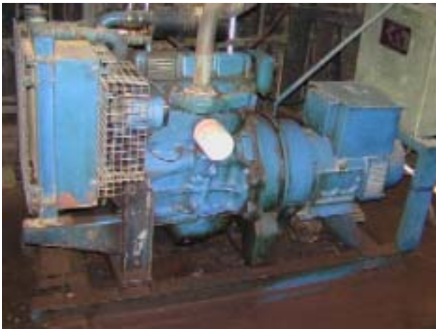
写真 1 - 5 ローレンチェリゲート操作の動力 を供給するジェネレーター
