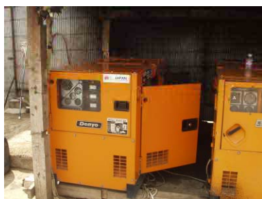
DU3 office の発電機 25kw
