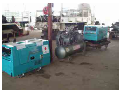
作業用発電機 11, 15KVA
