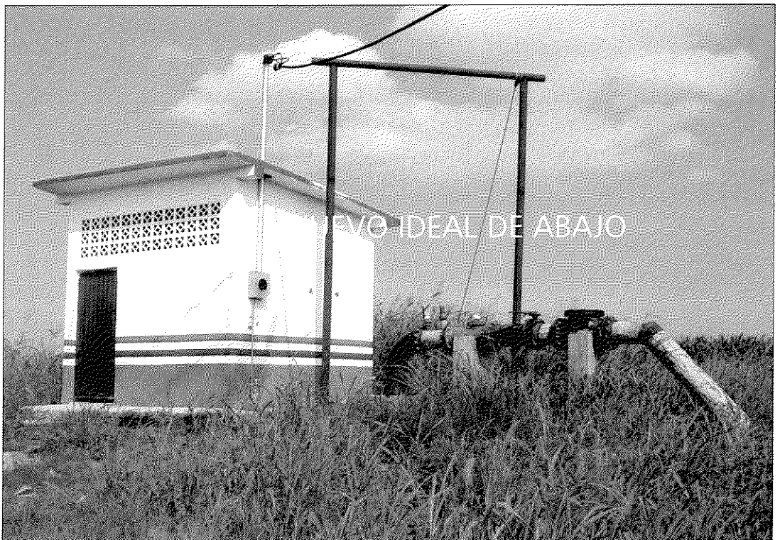
ESTACIÓN DE BOMBEO POZO 28
