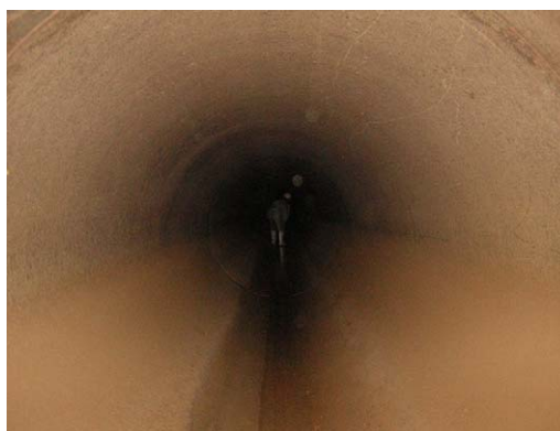
図 1.19 サイフォン内部状況写真
