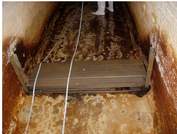
図 1.5 旧トンネル水位センサー下流の簡易堰
