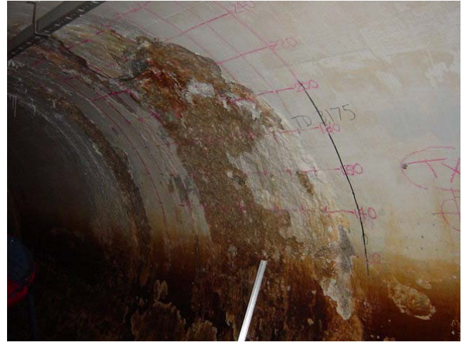
新トンネルのコンクリート劣化箇所 (TD 3,170 付近)。表層部が軟質化し剥離している。トンネル背面から供給される腐食性物質 (硫酸塩) によるものと判断され、補修が必要。
