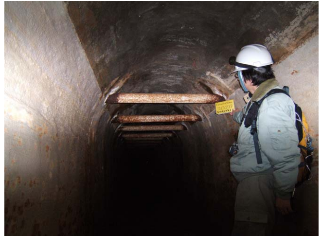
旧トンネル TD 13,740 付近の鋼管で補強された部分。1960 年代に設置。鋼管が錆びているため、補修が必要。
