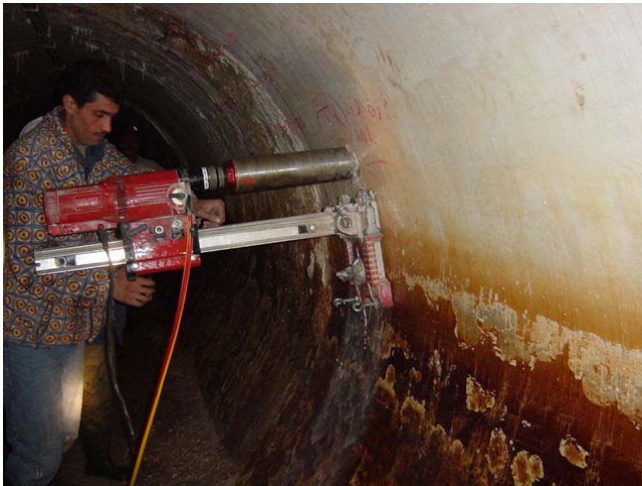
新トンネルのコンクリート内部の状態・強度を把握するために行われたコア採取。旧トンネルでも 5 箇所でもコアを採取し強度試験を行った。
