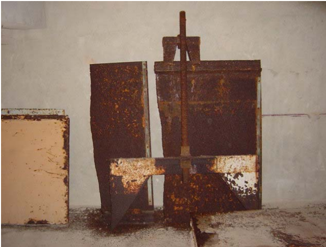
腐食して破損した旧トンネルのサイフォンパイプのゲート。耐食性の高い材質のゲートに交換が必要。
