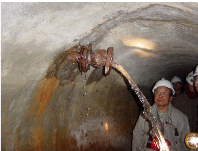
旧トンネル入口から 977.5 m には地上の湧水がトンネル内に鉄パイプを通して浸入している。右写真は地上部の湧水とピットを示す。水質管理上、鉄パイプを閉塞して止水すべきである。
