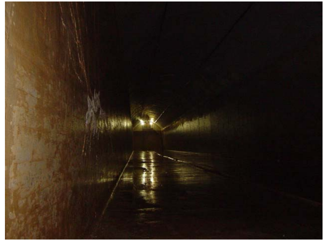
新トンネル出口にある新ワリ地下貯水池槽。長さ 160 m、幅 12 m、高さ 12 m。1 槽の容量は 15,350 m 3 で 4 槽ある。
