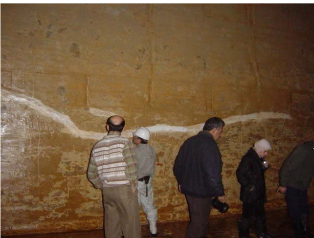
新ワリ地下貯水池槽 No.4 の壁面ひび割れの修理跡。壁面が孕みつつある、と言われている。
