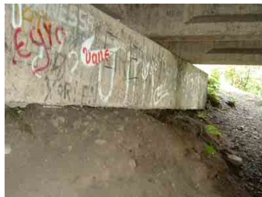
橋台前面土砂流出
