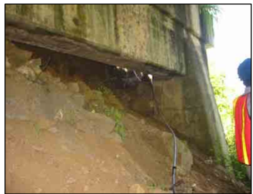
橋台前面盛土の崩壊
