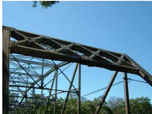
橋門構の損傷
