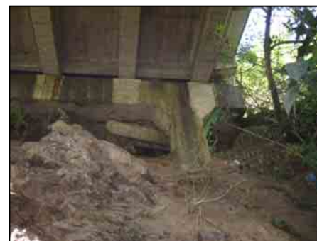
橋台前面盛土の崩壊
