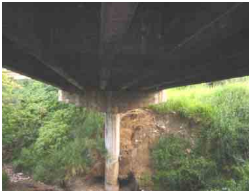
橋梁番号 30 国道 128 号線 橋脚洗掘例
