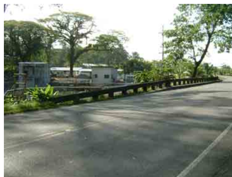
橋台の傾斜と杭 の破壊による桁 の沈下
