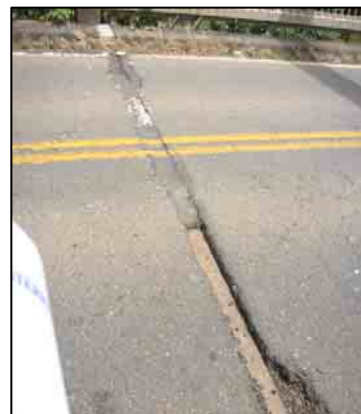
伸縮継手の損傷
