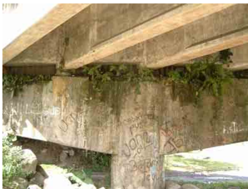
漏水による草、土
