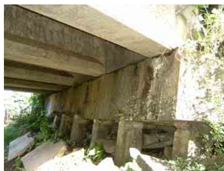
橋台の傾斜 と杭の破壊
