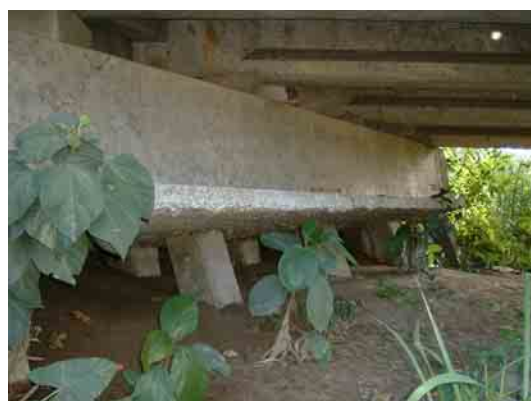
橋台の傾斜 と杭の破壊
