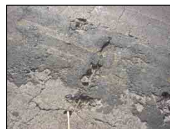
舗装と床版 のひび割れ
