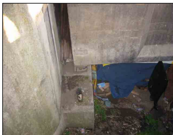
橋台の桁かか り長が短い
