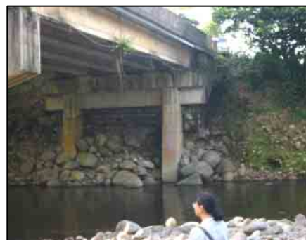
橋台前面盛土の崩壊
