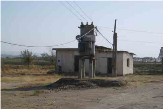
サルハチ農場 井戸ポンプ小屋と変電用 トランス設備、稼動中
