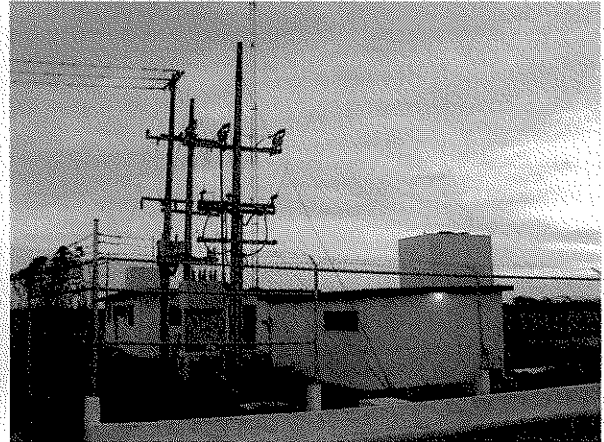
同左発電所内の変電設備
