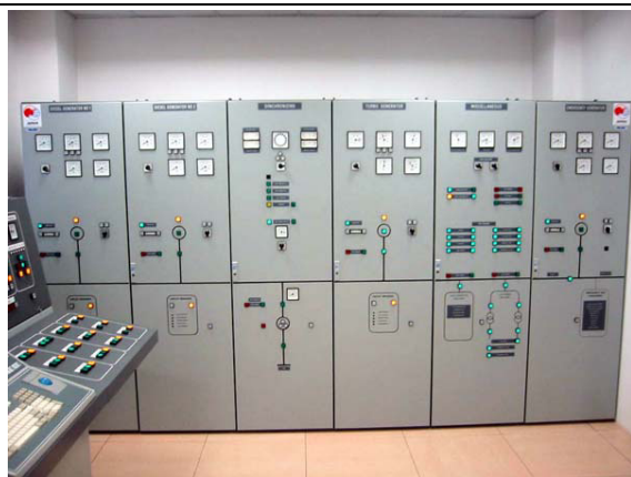
機関室シミュレータ：機関制御室発電機パネル
