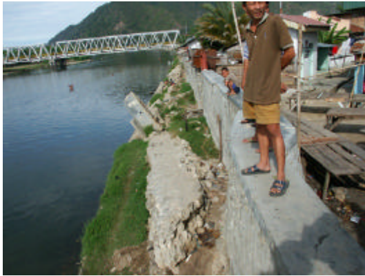
写真 3-5 2002年5月洪水で倒壊したボネ川右岸ブギス地区の洪水防護壁の残骸(現在は修復)
