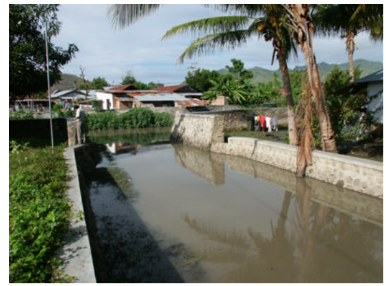
写真 5-6 排水路の流入地点(タマラテ川) : 堤防高が大きく違い、背水による浸水が発生
