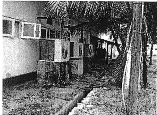
ICU 棟の空調室外機
