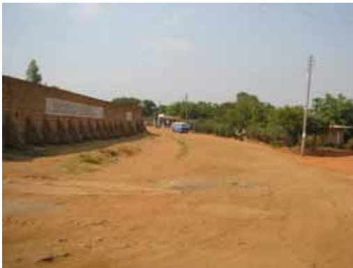
写真-3 道路の破損状況
