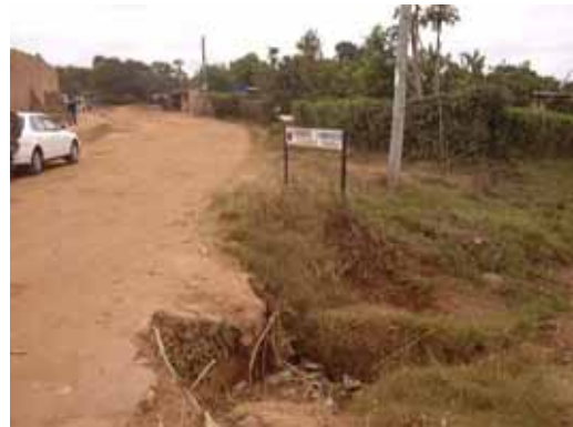
写真-4 排水施設の不足が舗装破損を加速させている
