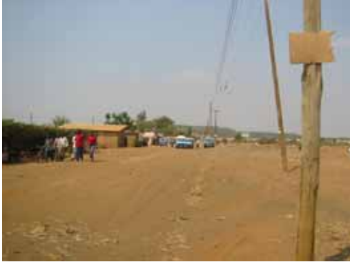
写真-1 バスターミナルにおける路盤と舗装の流出
