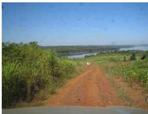
Caarendy 港付近の浸食を受けた接続道路
