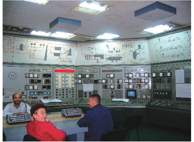
BOR 銅製錬所陰極中央制御室
