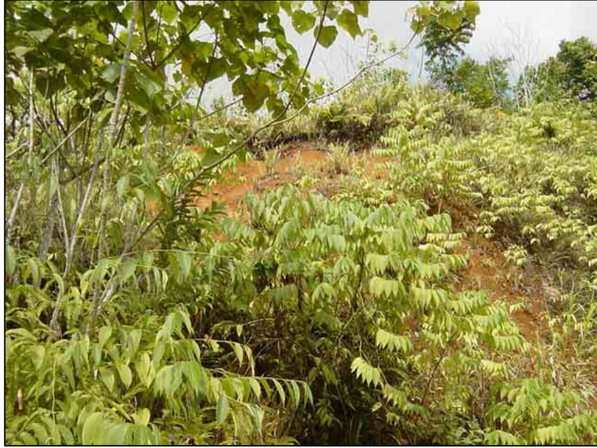
サラカタ水力発電所 取水路 斜面侵食状況
