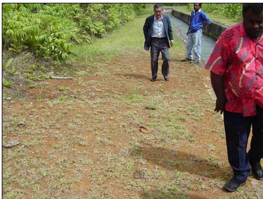
サラカタ水力発電所 取水路 斜面侵食による土粒子堆積状況
