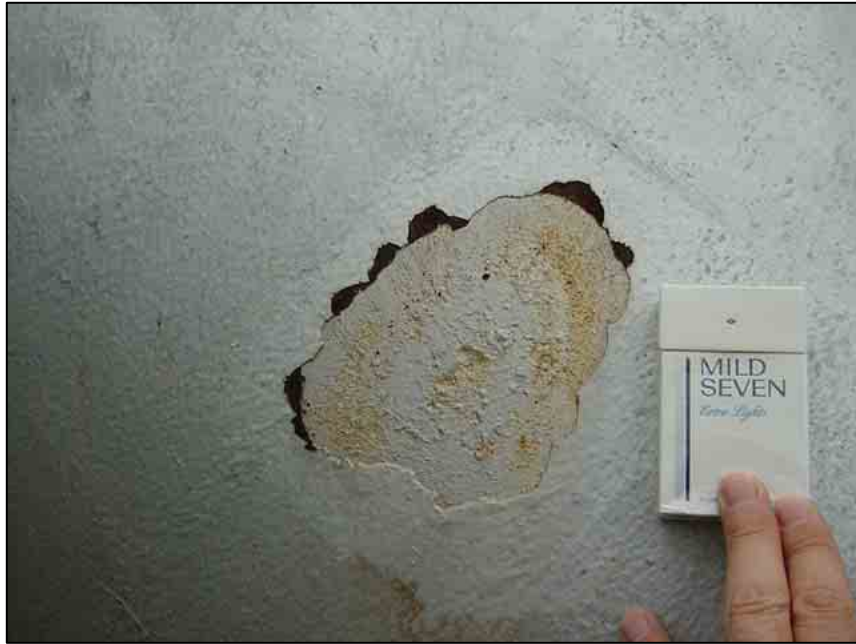
水圧鉄管 1・2号機用 経年による塗膜の劣化(1)
