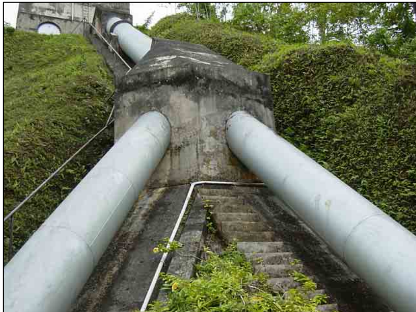
サラカタ水力発電所 水圧鉄管分岐 右から1・2号機用
