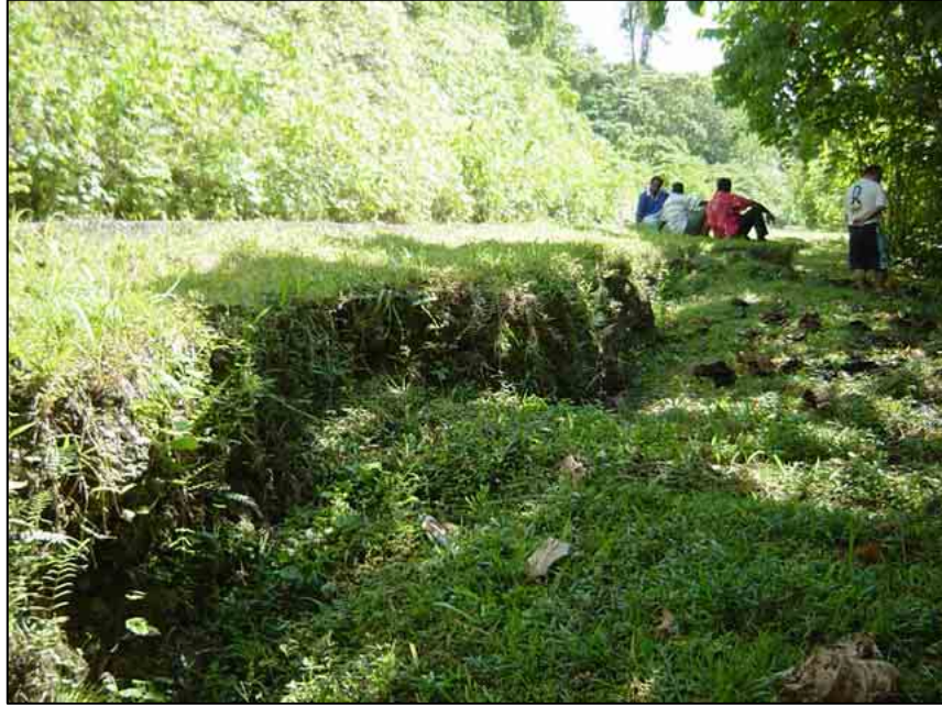
サラカタ水力発電所 取水路 地山のクラック状況(1)
