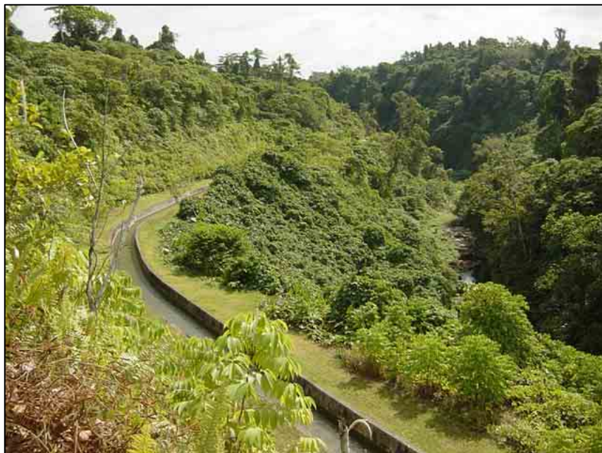
サラカタ水力発電所 取水路
