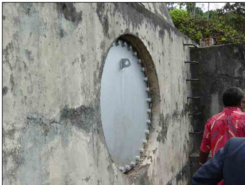
サラカタ水力発電所 水槽 3号機用水圧鉄管取り付け蓋
