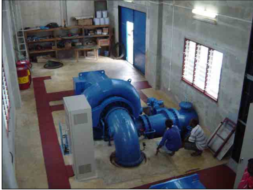
サラカタ水力発電所 2号水車発電機(300kW)
