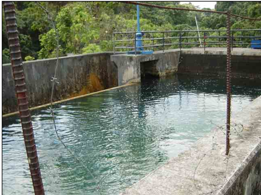
サラカタ水力発電所 水槽
