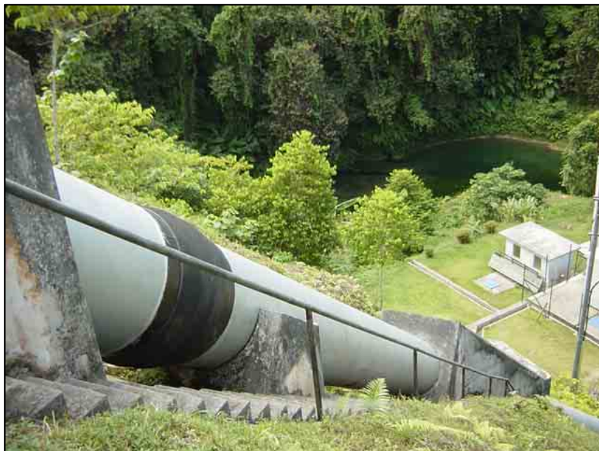
サラカタ水力発電所 水圧鉄管 1・2号機用（可とう管付鉄管）
