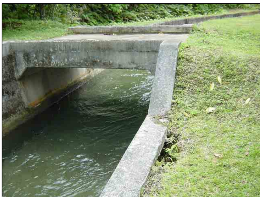
サラカタ水力発電所 取水路 背面地山の空隙状況
