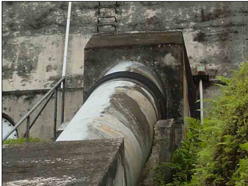
水圧鉄管 1・2号機用 経年による塗膜の劣化(2)
