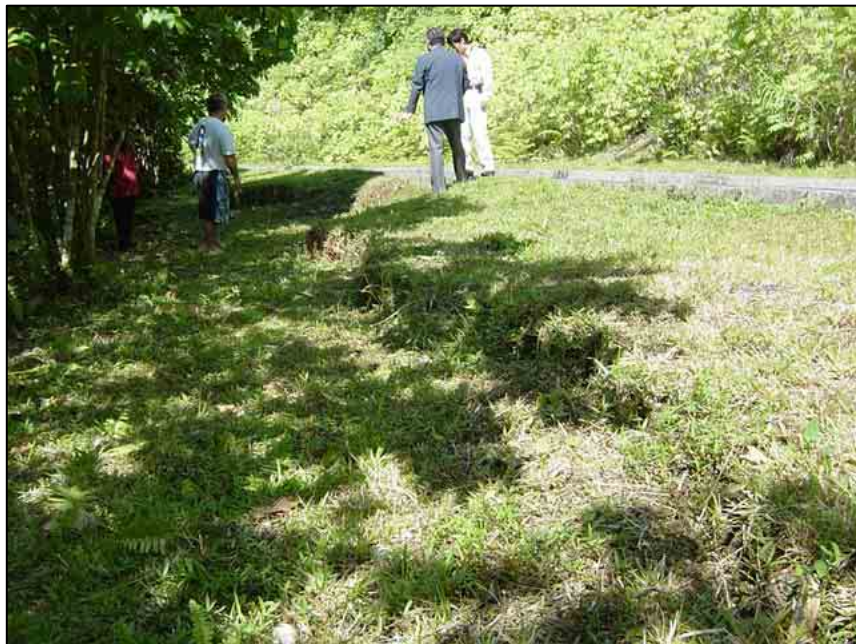
サラカタ水力発電所 取水路 地山のクラック状況(2)
