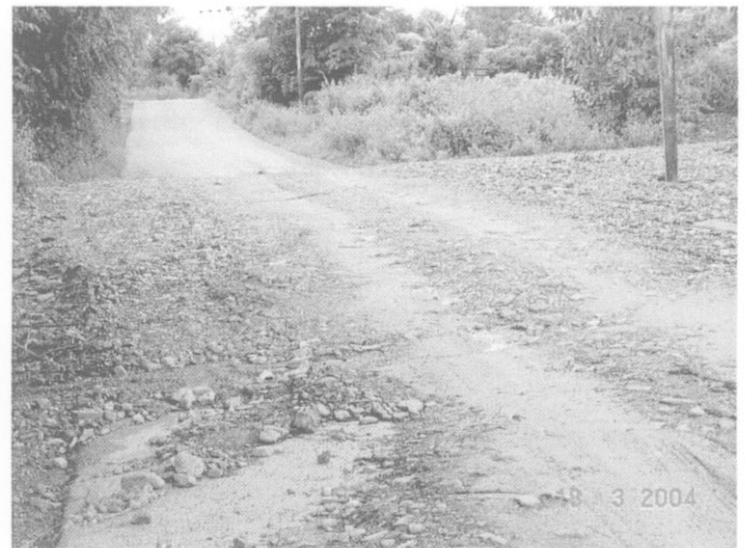
道路が冠水して堆積した土砂
