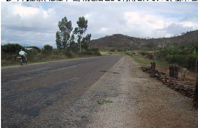
【サイト】国道6号線の状況、シモイオとジンバブエを結ぶ。
