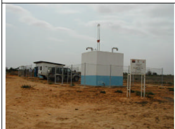
写真-15 Binfica II 給水施設、 手前は貯水槽、後方は発電機室。
