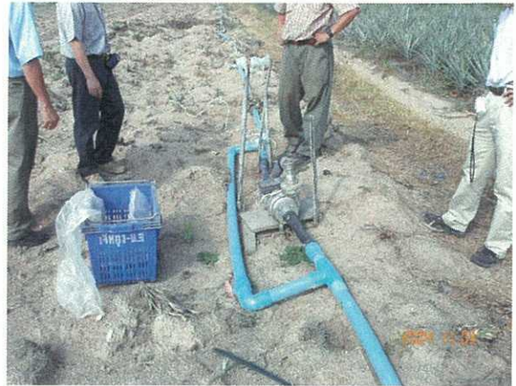
農家により導入された ブースターポンプ
