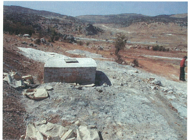
ヤブース水源地 シリア国側が掘削した生産井戸 No.11、この井 戸に日本側が調達した水中ポンプを据付ける
