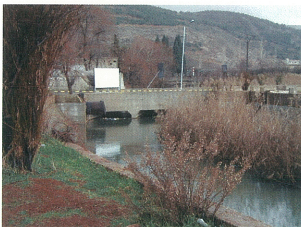
ヤブース導水管路線 タケア減圧槽手前にあるバラダ川横断部
